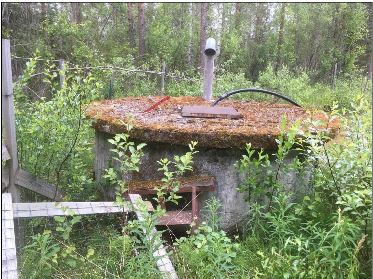
Kuva 4. Pohjaveden tutkimuspisteen pumppaamo.
